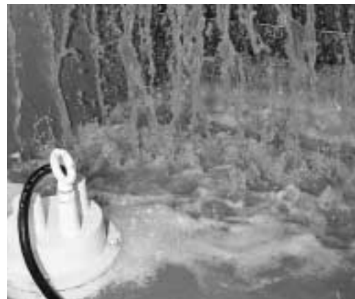
El agua filtrada se recolecta en un tanque para ser descargada al alcantarillado o para ser recirculada al sistema de pelado.
